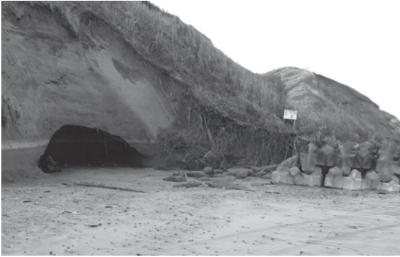
第9図 消波ブロック背後の崖錐が侵食された状況 もともと消波ブロック端の背後には、崖錐のないわずかなスペースがあったが、崖錐が侵食され広いスペースになった。2014年12月20日撮影。
